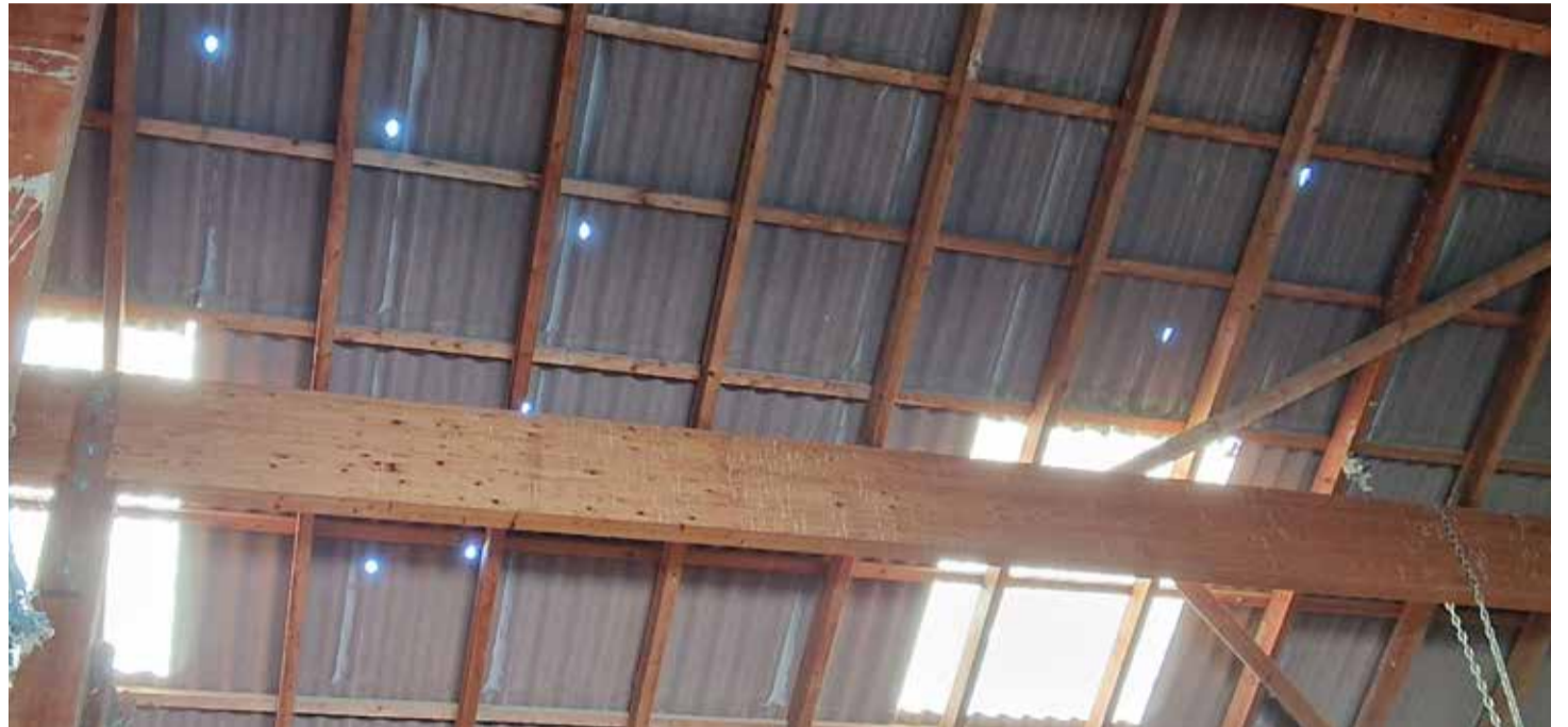
Hagelschaden am Dach mit sichtbaren Durchschlägen.
