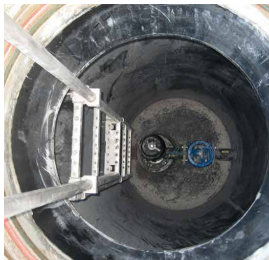
Einblick zur Grundwasserpumpe
